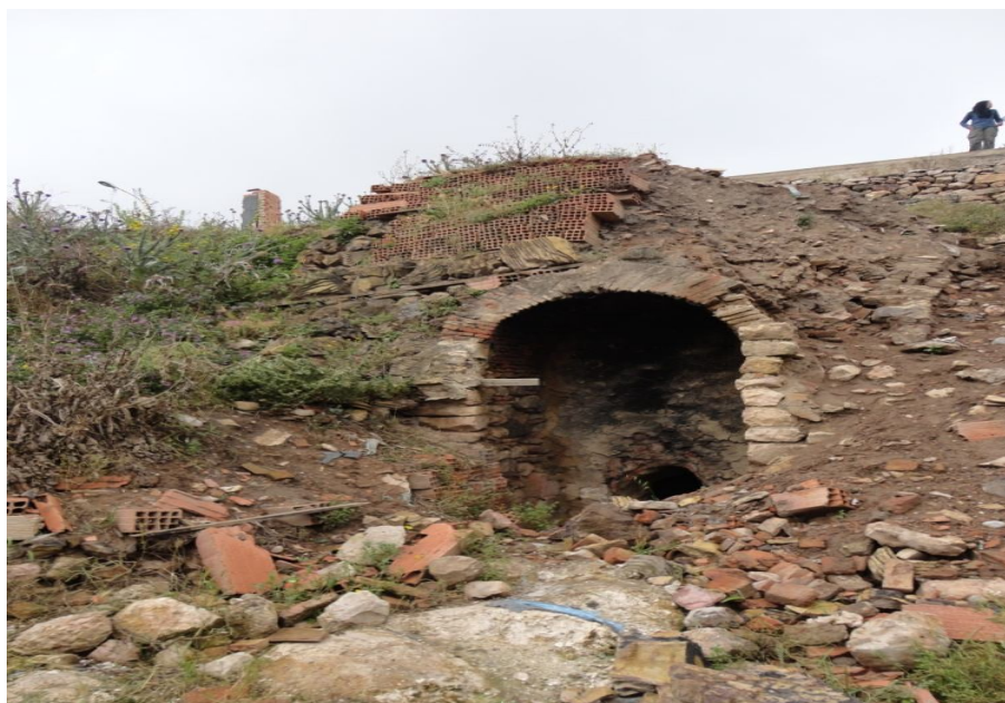
الفرن قبل التنظيف والترميم
